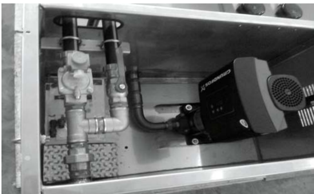
Gruppo di immissione acqua. Valvola solenoide e valvola a sfera per riempimento manuale. Presa di rete 1" 1/4 GAS femmina
