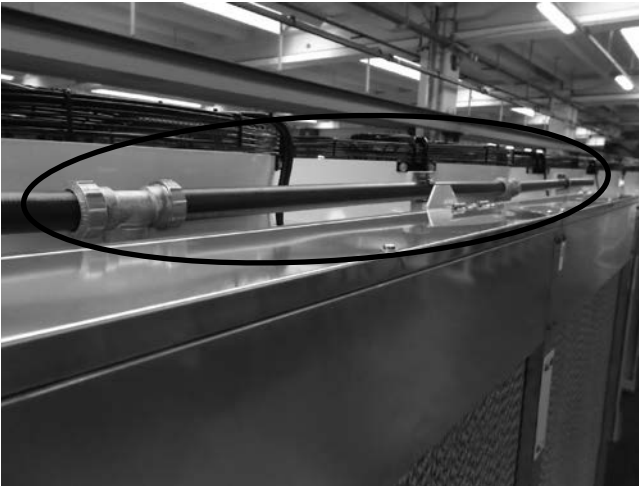
Particolare tubazione rampa
